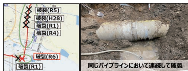
図－５ 突発事故被害の事例（パイプライン）
