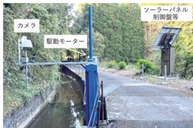
写真-3 水門遠隔操作監視システム
