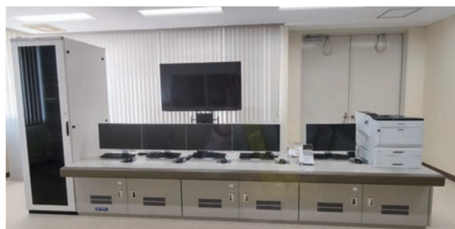
写真－2 中央管理所設備
