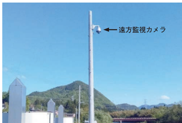
写真－5 遠方監視カメラ
